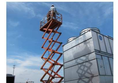
冷却塔噪音等级测试
